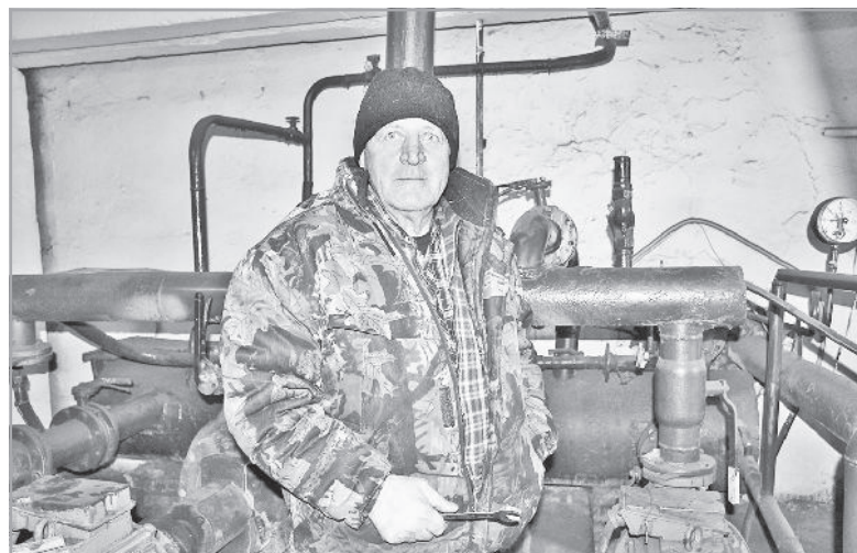
Слесарь-ремонтник В.В. Перельгин обслуживает насосное оборудование одной из котельных райцентра.
